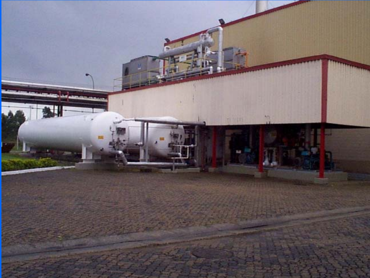
Vista de tanques de anidrido carbônico
