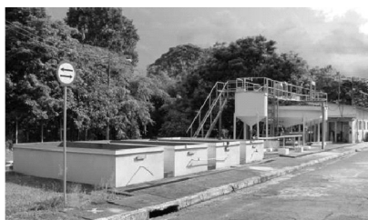
Figura 6.17 Estação de Tratamento de Efluentes (ETE)
